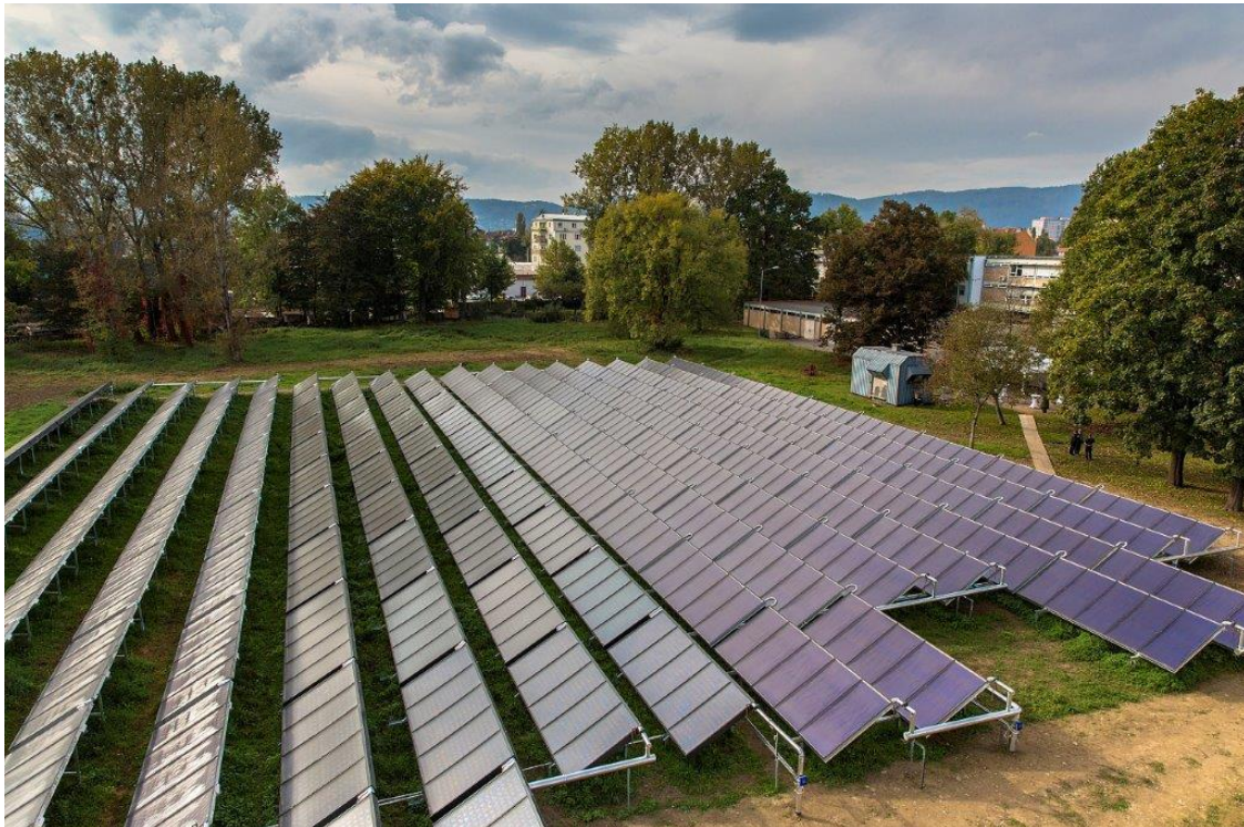
Abbildung 70: Solaranlage am Areal der Fernwärme-Zentrale Graz Quelle: Energie Steiermark Wärme GmbH
